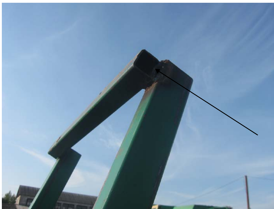
Рисунок А.8 – Погрузчик транспортировщик рулонов ТП-10. Отрыв верхней планки заднего борта. Вид после восстановления
